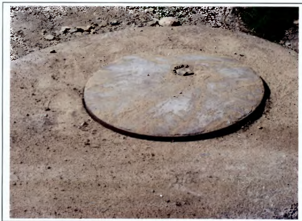
Foto N° 3 Falta reposición de tapa de cámara de inspección N° 2
