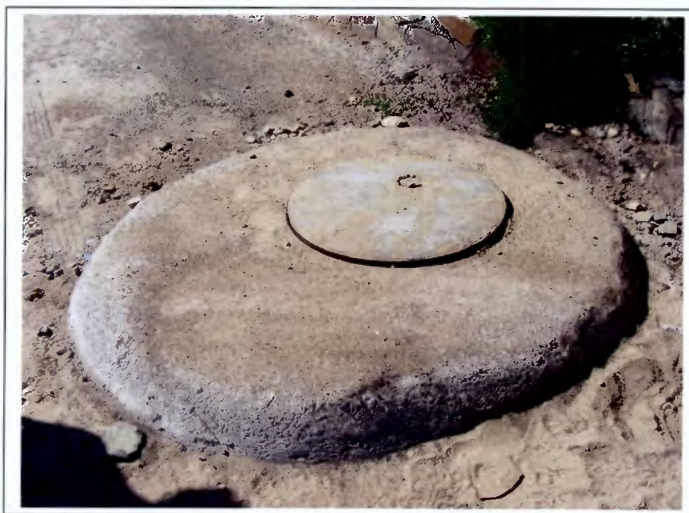
Foto N° 4 Falta reposición de tapa de cámara de inspección N° 2
