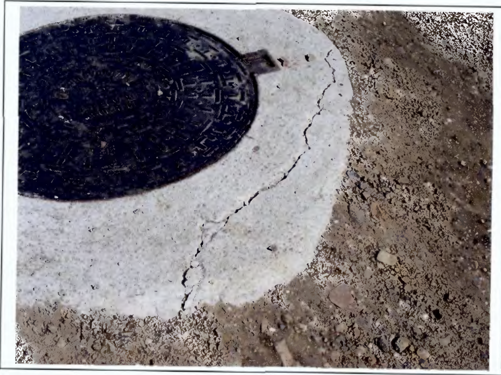
Foto N° 1 Falla de hormigón de losa Cámara de Inspección N° 4.
