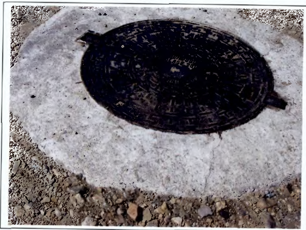
Foto N° 2 Falla de hormigón de losa Cámara de Inspección N° 4.
